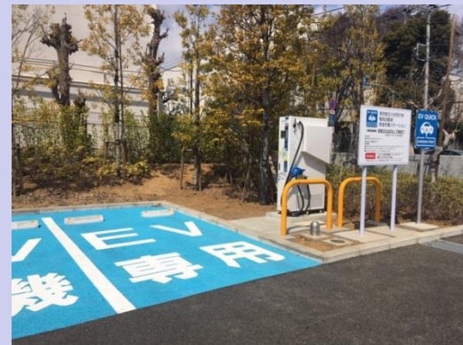
急速充電器（立川合同庁舎）
