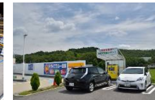
急速充電器のほか普通充電用コンセントも備え、EVだけでなくPHVにも対応
