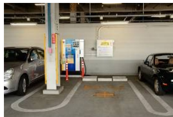
市が駐車場に設置した社会実験用の急速充電器
