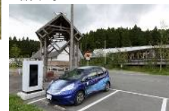
急速充電器と普通充電器が設置されている「道の駅波野」
