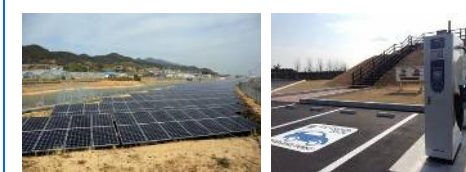
㈱グリハントが運営するあわじ佐野新島太陽光発電所には急速充電器が2基設置されている(工事中に撮影)
