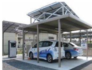
始発駅・龍原の充電用ソーラーパネルと蓄電池付きの駐車場は県民が実証実験中
