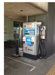
神奈川県庁に設置された急速充電器も現在は無料で利用できる
