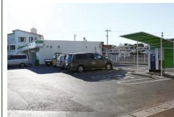
ファミリーマートの駐車場に設置された急速充電器。利用は1回500円
