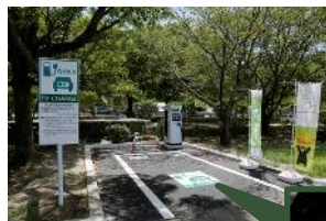
充電用駐車スペースの地面にもロゴが貼られている
