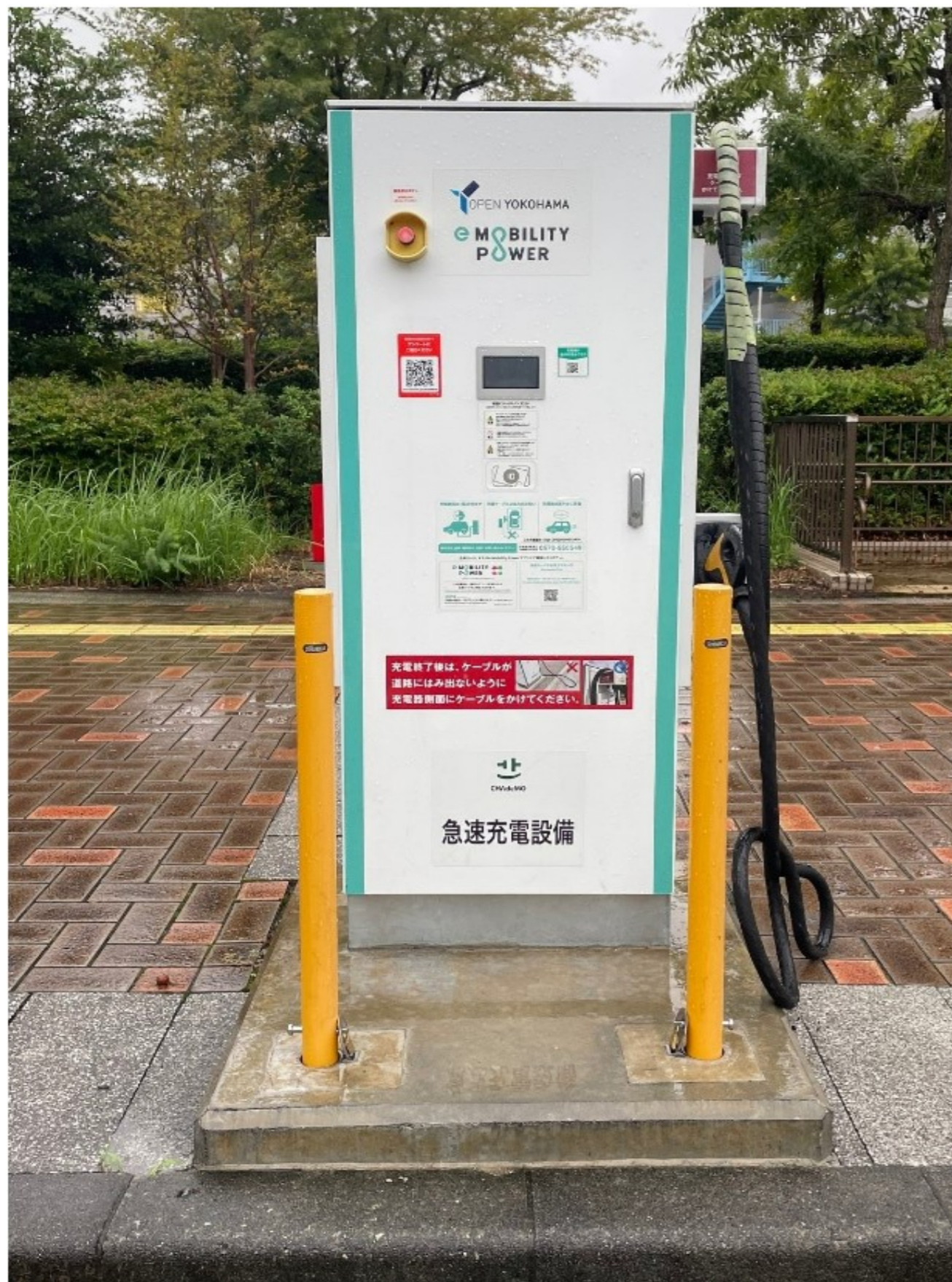
要部写真(充電設備および充電設備防護用部材全景)
