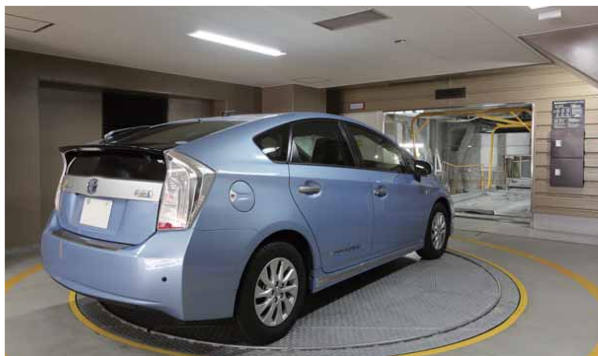
8階建てオフィスビルに設置された回転式立体駐車場である阪本ビル駐車場(新明和工業製)は、テナントとして入居する企業を中心に29台を収容可能。格納中に充電できる充電設備を3台新設し、フル稼働している。
