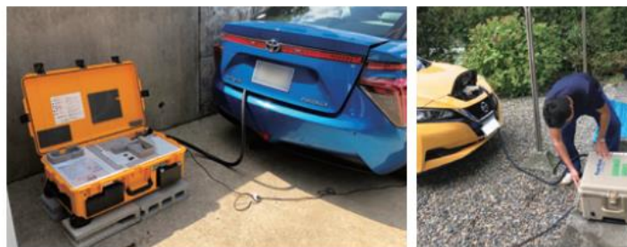
停電地域での給電の様子
