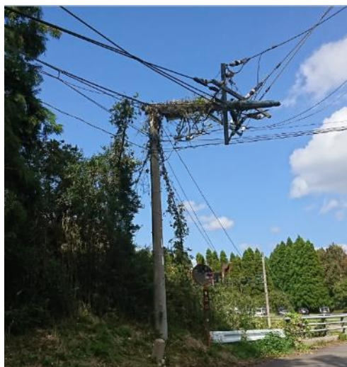
折れた配電柱
